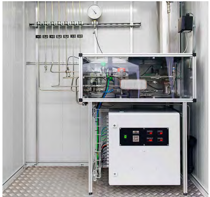
Gaznat SA poursuit ses activités dans le domaine du développement des gaz renouvelables et lance une plateforme innovante – Innovation Lab, à Aigle – qui accueillera de nouvelles installations.
