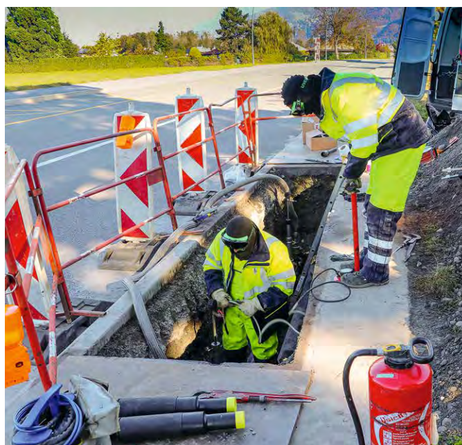
Assainissement d'anciennes conduites de gaz naturel à Rennaz, sur le réseau de la Société du Gaz de la Plaine du Rhône SA.
