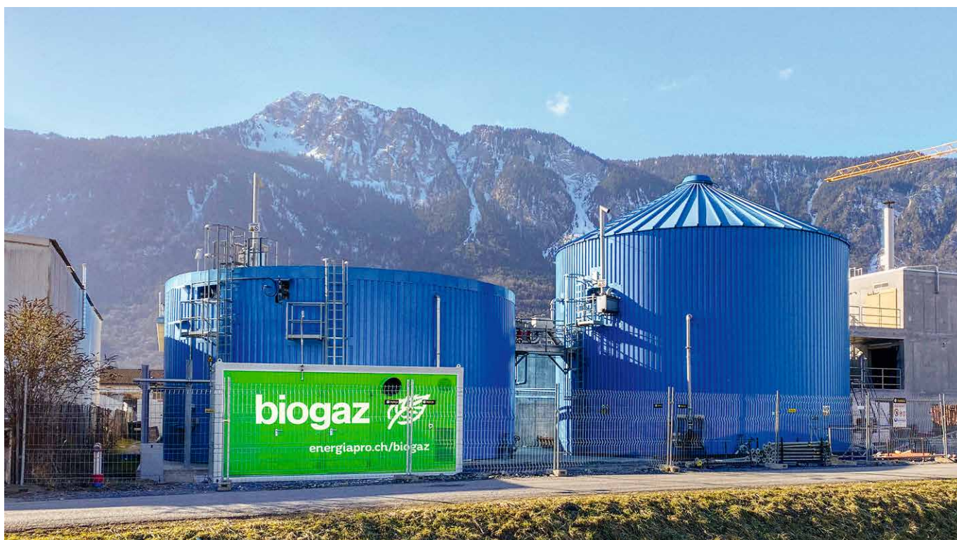
Une nouvelle installation de biogaz a été mise en service à la STEP de Collombey-Muraz. La production de biogaz issue du digesteur de la STEP est traitée puis injectée dans le réseau de gaz du groupe HOLDIGAZ.
