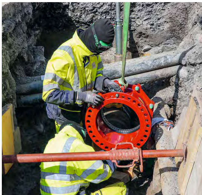
Assainissement d'anciennes conduites de gaz naturel sur la commune de Montreux, sur le réseau de la Compagnie Industrielle et Commerciale du Gaz SA.
